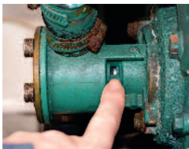
1 Tässä on vesipumpun vuotoreikä. Useimmiten pumpusta hajoaa vesitiiviste, mutta joskus reiästä saattaa tippua öljyä.
