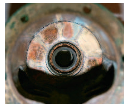
8 Pumpun sisällä näkyy rikkoonnut stefa, jonka reunalle on syntynyt ruostejälkiä.
